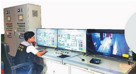
集中控制室 Centralized Control Room
