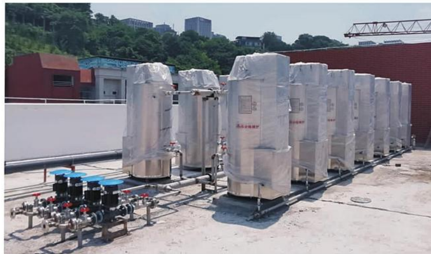
户外型商用容积式燃气热水炉直燃直供现场图
